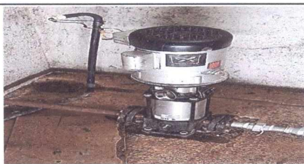
Foto 5: Bomba de agua que suministraba en el centro educativo se encuentra inservible
