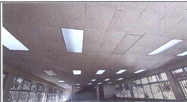
Foto 2: Panel LED que no funcionan en diferentes áreas
