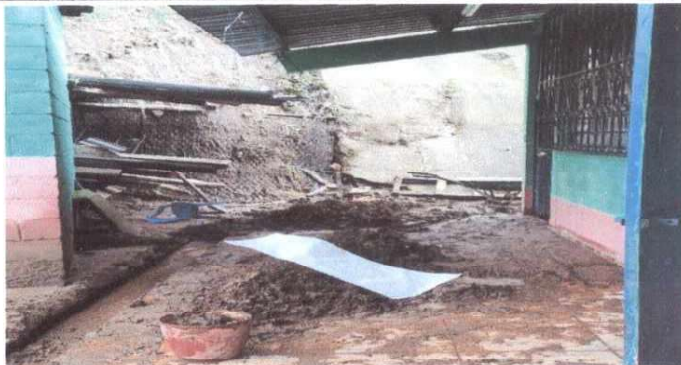
Foto 2: la escuela quedo inundada de lodo
