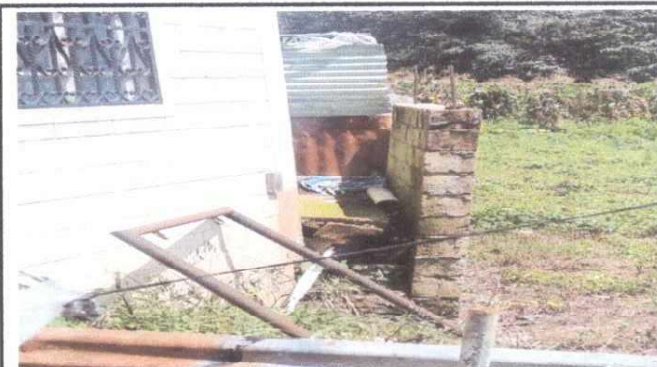
Foto 4: muro perimetral en mal estado a punto de caer
