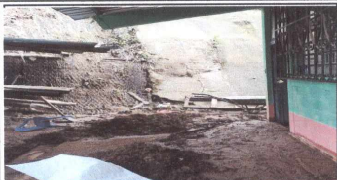
Foto 1: Deslave por lluvias y toda la tierra cae dentro del establecimiento
