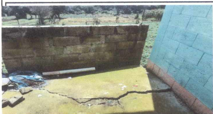
Foto 3: la pared es colapsando debido al desmoronamiento de tierra
