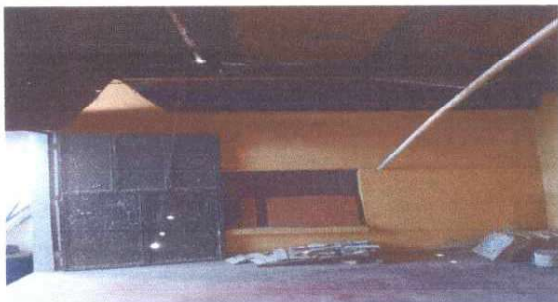
Foto 1: Láminas en mal estado
