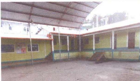
Foto 2: Deterioro de color de las paredes del Centro Educativo
