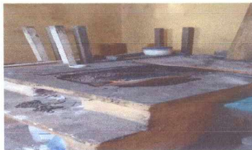
Foto 6: Plancha en mal estado
