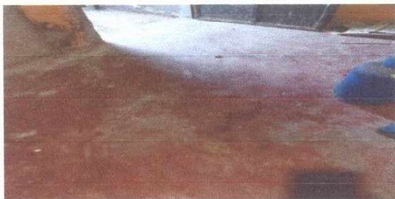
Foto 5: Piso en mal estado
