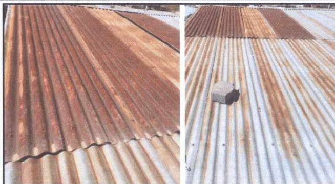
Foto1: CUBIERTA DE LÁMINA EN MAL ESTADO
