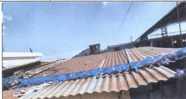
FOTO 1: Techo en mal estado
