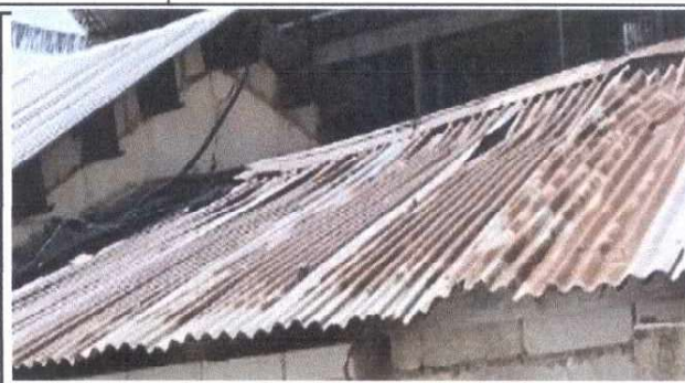
FOTO 2: Techo en mal estado
