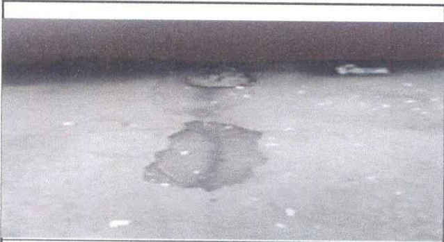
Foto 3: El despegue de la torta de cemento en el patio de la Escuela
