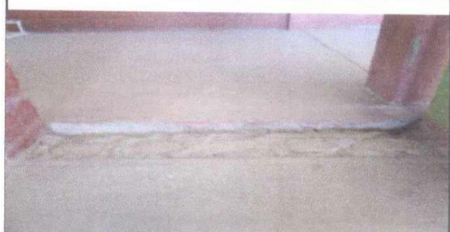
Foto 2: La mala terminación del piso líquido del corredor de las aulas
