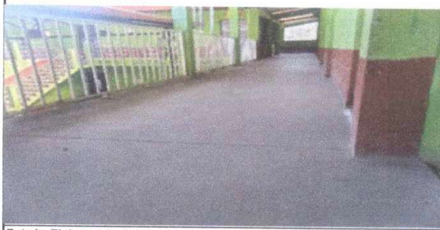
Foto 1: El desgaste del piso líquido del corredor de las aulas
