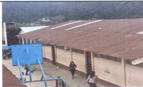
Foto 2: LAMINAS CON GOTERAS PROFUNDAS
