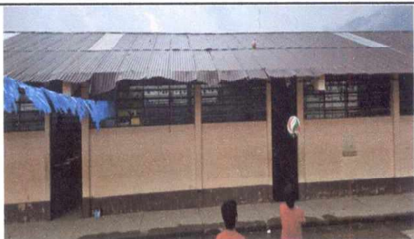
Foto 3: LAMINAS EN MAL ESTADO, POR LOS 36 AÑOS DE USO
