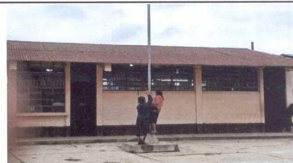
Foto 6: LAMINAS DAÑADAS NECESITA REEMPLAZO
