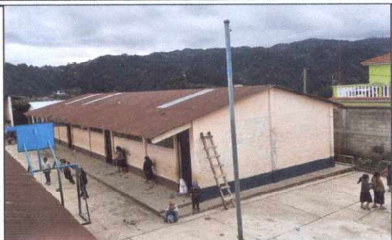
Foto 1: DETERIORO DE LAS LÁMINAS
