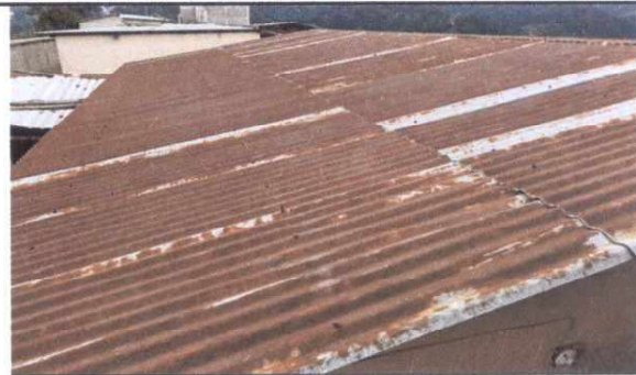
Foto 4: CUBIERTA DE TECHO DE LÁMINA REQUIERE MEJORAMIENTO
