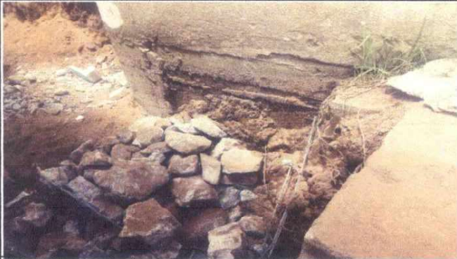
Foto1: Se necesita de urgencia la reparación del muro perimetral
