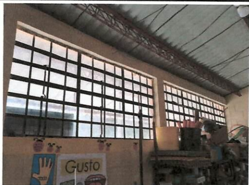
Foto1: Las ventanas son antiquísimas y debido a eso no se pueden abrir.
