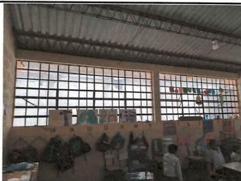
Foto 2: Las ventanas son antiquísimas y debido a eso no se pueden abrir.
