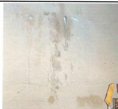
Foto 6: Humedad generada por la filtración de agua, lo cual provoca deterioro de la pared y la pintura.
