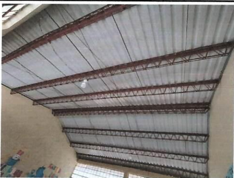
Foto 5: El techo es de lamina y filtra el calor.
