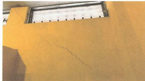
Foto 6: paredes de los sanitarios de varones
