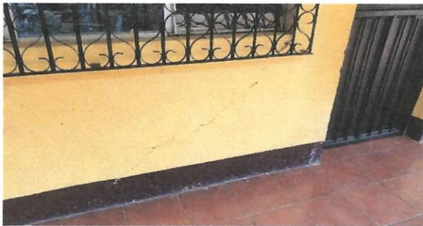
Foto 3: Grietas en paredes de salón 2
