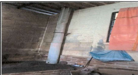
Foto 3: SUMINIS. Y MEJORAMIENTO DE CHIMENEA DE ESTUFA DE LEÑA
