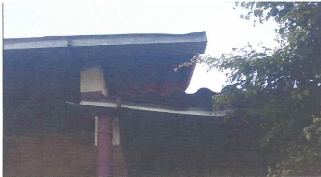
Foto 3: se muestran los canales en mal estado del modulo 2
