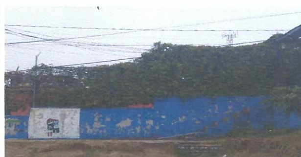
Foto 10: continuación del encaminamiento al modulo 1 falta de techo.
