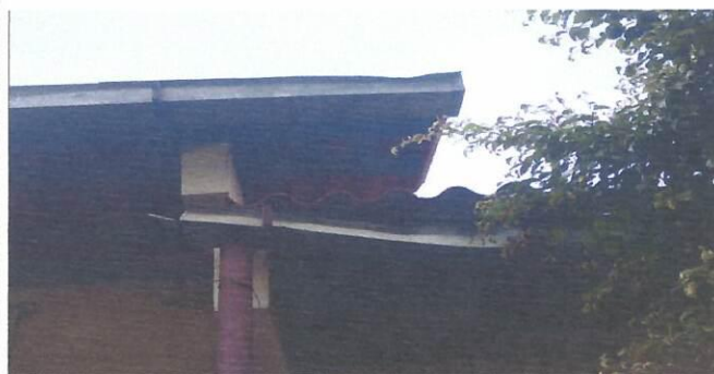
foto 11: se muestran los canales en mal estado
