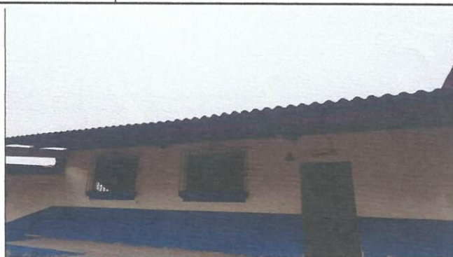
foto 8: se muestra la continuación del módulo 1 donde no existen canales
