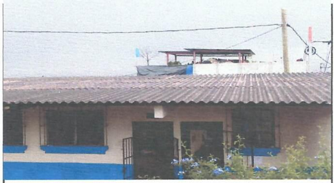
Foto 4: se muestra el modulo 1 donde no existen canales.
