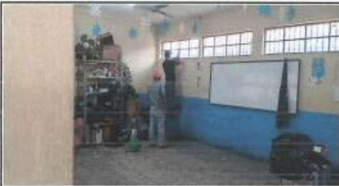
Foto 4: Salon de clases sin ventilación
