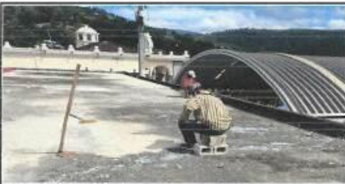
Foto 5: Losa en mal estado.
