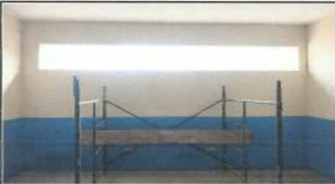
Foto 3: Salon de clases sin ventilación
