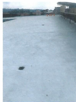
Foto 2: terraza del edificio con una sola capa de impermeabilización.
