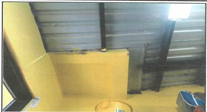
Foto 2: Interior de salón de clases presentando filtración de agua del techo.
