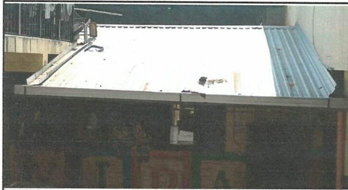
Foto 1: Estado actual del techo presentando filtración de agua dentro del salón, en una de las esquinas de la losa hay mucha filtración de agua.
