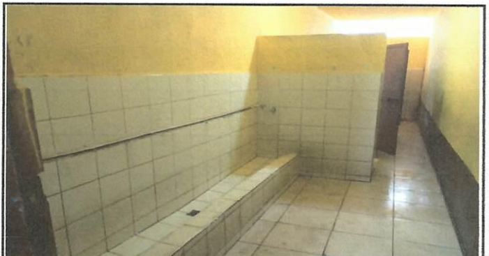
Foto 4: Estado actual del azulejo del mingitorio de los niños, teniendo necesidad de sustituirlos.
