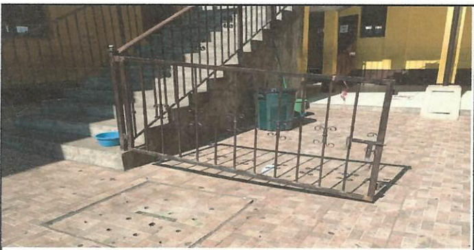
Foto 5: Puera de reja en mal estado.
