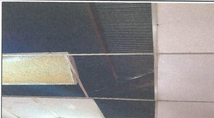
Foto1: Cielo falso en uno de los salones.
