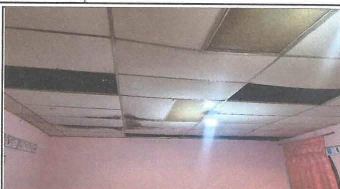
Foto 2: Cielo falso en uno de los salones.
