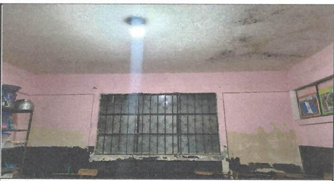
Foto 5: Ventanas en desuso en uno de los salones.
