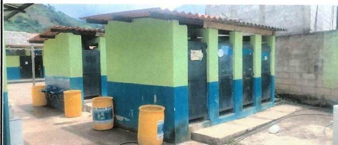
Foto1: Estado actual de los dos módulos de sanitarios
