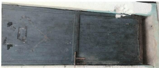
Foto 6: Estado actual de las puertas del sanitario
