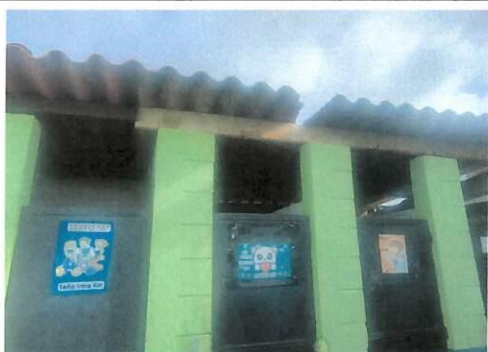
Foto 5: Cubierta de los sanitarios en mal estado
