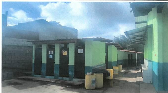
Foto 2: cubierta de los sanitarios en mal estado.
