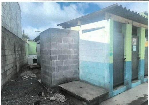
Foto 3: Estado actual del piso de cemento y una parte de tierra del primer módulo de sanitarios
