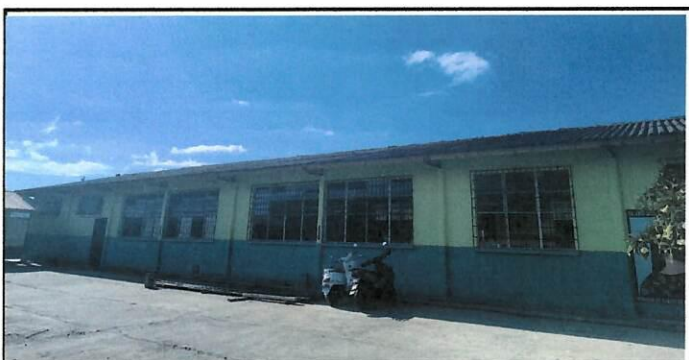
Foto 5: Estado actual del techo del lado de atrás
