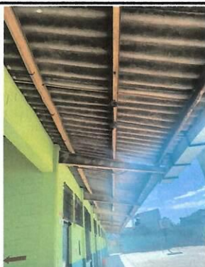
Foto 3: Estado actual del techo del lado oeste
