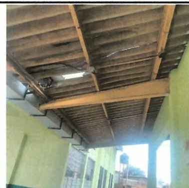
Foto 4: Estado actual del techo del lado oeste
