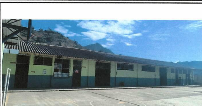
Foto 2: Estado actual del techo del módulo del lado oeste
