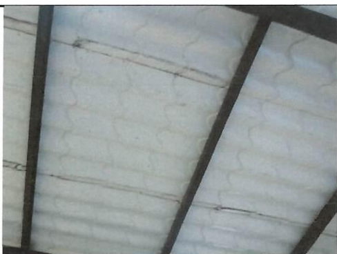
Foto 5: TECHADO EN MAL ESTADO DE ALGUNOS SALONES, AL MOMENTO DE LLOVER TIENEN GOTERAS
