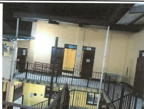
Foto 2: GRADAS DEL CENTRO EDUCATIVO, FALTA DE ESTRUCTURA DE TECHO Y CUBIERTA DE LAMINA, LLUVIA ENTRA A LOS CORREDORES PONIENDO EN RIEGO A LOS ESTUDIANTES
