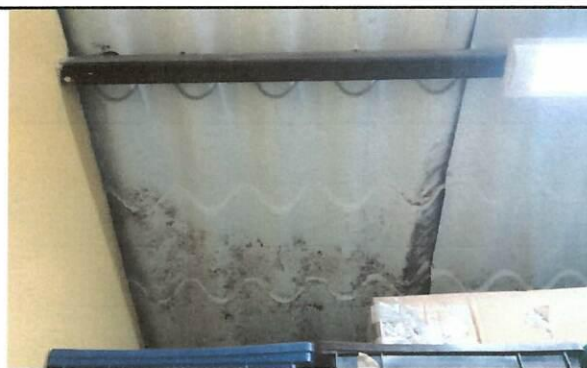
Foto 6: LAMINAS EN MAL ESTADO AL MOMENTO DE LLOVER EL AGUA ENTRA EN ALGUNOS SALONES.
