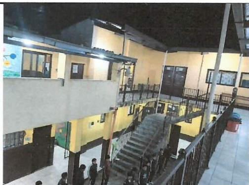
Foto 3: PATIO CENTRAL SIN CUBIERTA DE LAMINA, FALTA DE ILUMINACION CORRECTA, FALTA DE CANALES Y BAJADAS DE AGUA PLUVIALES
