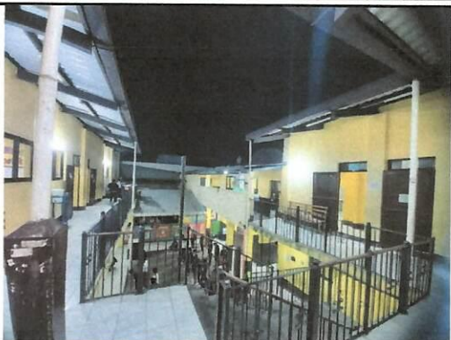
Foto 1: PATIO DEL ESTABLECIMIENTO EDUCATIVO CENTRAL. FALTA DE MANTENIMIENTO ILUMINACION, ESTRUCTURA DE TECHO Y CUBIERTA DE LAMINA
