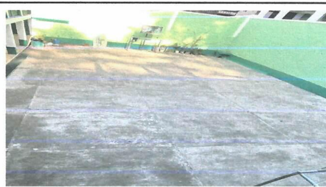
Foto 4: área de la cancha, que necesita ser limpiada y señalizada.
