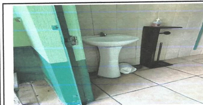
Foto 11: lavamanos que necesitan ser cambiados.
