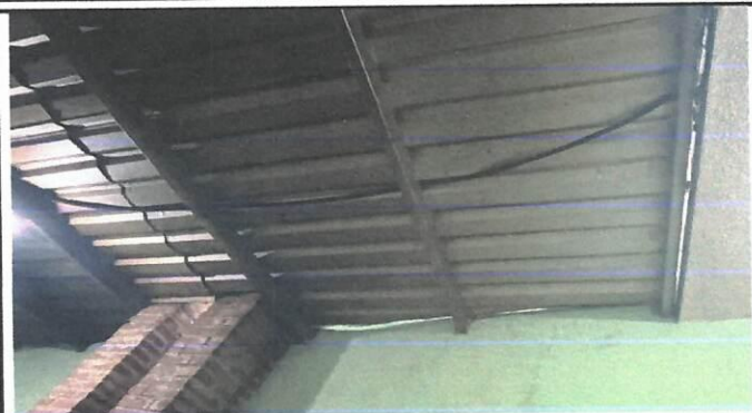
Foto 7: área de cocina donde se filtra el agua
