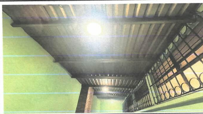
Foto 8: iluminación en área de cocina
