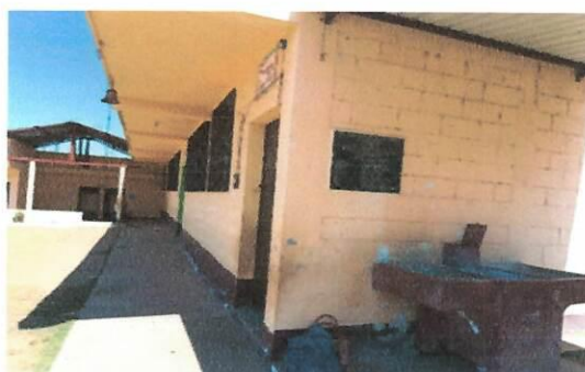
Foto 4: Imagen de la fachada de la Escuela Oficial de Párvulos, la cual necesita mantenimiento en lo que se refiere a la pintura.
