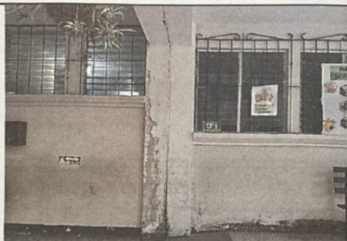
Foto 3: En la fotografía se observan las ventanas a cambiar por marcos PVC corredizos. Se evidencia la necesidad de pintura en paredes y zócalos.
