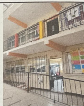
Foto 4: Las barandas y balcones de toda la escuela necesitan pintura, también se tiene contemplada la pintura interior y exterior de las aulas.
