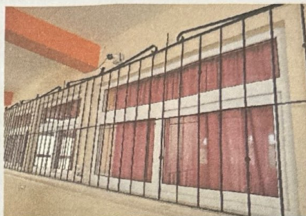
Foto 2: Las ventanas no tienen mosquiteros y los balcones presentan óxido.
