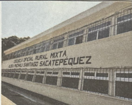
Foto1: Se observa que ninguna ventana posee mosquitero lo que permite la entrada de insectos. Los balcones y las paredes necesitan pintura.
