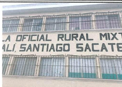
Foto 2: Los vidrios que dan hacia la calle son transparentes y se están desprendiendo lo que representa un riesgo por la visibilidad de afuera hacia adentro tanto por el resguardo de los niños como por el mobiliario y equipo.
