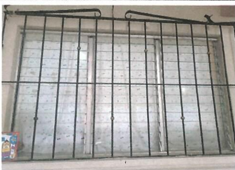
Foto 3: En la fotografía se observan los vidrios de paleta que están sostenidos con un sistema de pinzas lo que ocasiona que se desprendan fácilmente, se caigan y se rompan.
