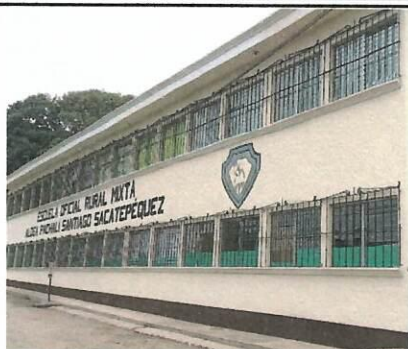
Foto 1: Las ventanas hacia la calle tienen estructura de aluminio con paletas de vidrio. Las estructuras están deformes, muchas vidrios se están cayendo, otros ya no cierran produciendo entrada de polvo y viento a las aulas.
