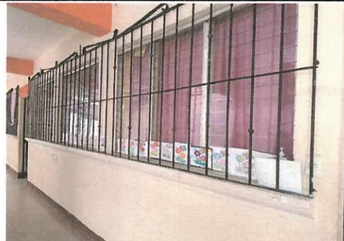
Foto 4: Otro ángulo de las ventanas con estructura de aluminio y paletas de vidrio sostenidos por un sistema de pinzas. El sistema de apertura deforma el aluminio produciendo que no se puedan abrir o cerrar.
