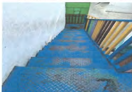
Foto 11: Necesidad de Pintura de huellas, antideslizantes en las gradas
