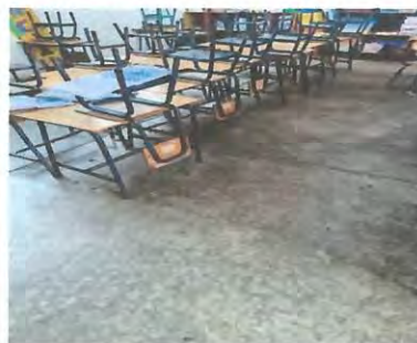
Foto10: Necesidad de piso cerámico aula No. 3
