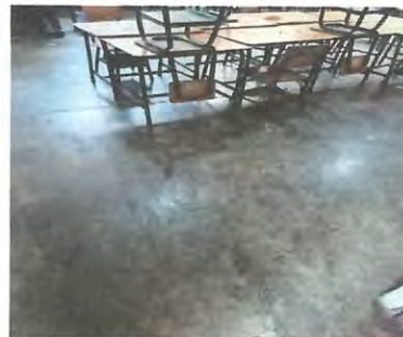
Foto 8: Necesidad de piso cerámico aula No. 1
