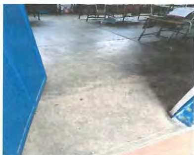
Foto 9: Necesidad de piso cerámico aula No. 2
