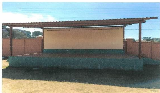
Foto 3: Imagen del escenario, que presenta diferentes riesgos para los niños (as), por la deficiencia de agrietamiento de la base del piso, e inseguridad por no contar con barandas, para resguardar la salud física de los niños de 2,3,4,5 y 6 años.
