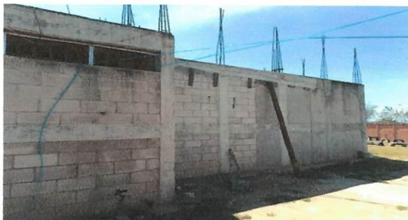
Foto 1: Imagen de la pared de la parte exterior de aulas, que tienen problemas de filtración de humedad, la cual afecta la salud de los niños y niñas que reciben clases en los diferentes salones.
