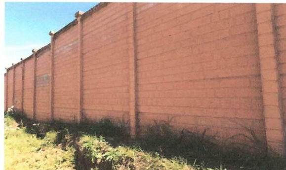
Foto 2: Imagen del muro perimetral COPB, que resguarda la seguridad de los niños y niñas, y que actualmente presenta socabamiento en el paderon la cual provoca problema de riesgo para la integridad física de
