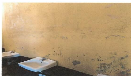
Foto 4: Imagen de una de las partes de los servicios sanitarios, que actualmente presentan problemas de filtración de humedad, como mal estado de sanitarios, lavamanos y mingitorio.
