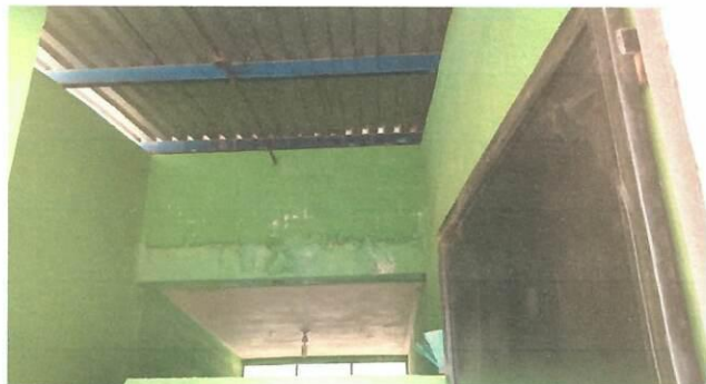
Foto 1: Remozamiento de loza, ya que presenta filtración en época de invierno.
