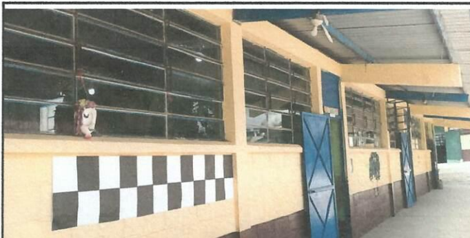
Foto 4: Renovar la pintura de las aulas interior, exterior y las puertas de metal.
