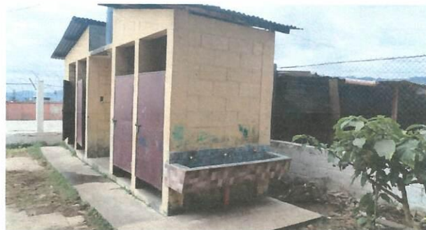
Foto 2: La necesidad de colocación de techo para que los alumnos no sufran de las inclemencias del clima.
