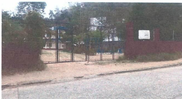
Foto 1: fotografía de la parte frontal del establecimiento externo. en esta fotografía se muestra el estado actual e inseguro en el que se encuentra el porton de la entrada principal del establecimientos, medida de 5 metros
