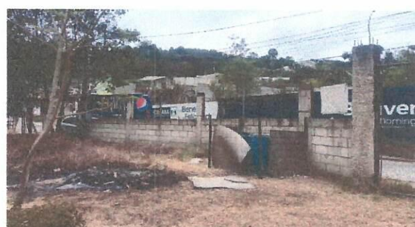
Foto 4: fotografía de la parte frontal del establecimiento interna. Esta imagen muestra el muro perimetral de la parte de frente y en que condiciones se encuentra el mismo.
