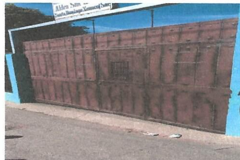
Foto 2: Se observa la necesidad de mantenimineto de porton en pintura y cambio de chapa
