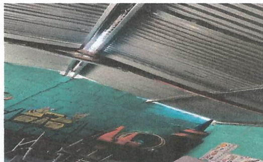
Foto 4: vista general de techo en mal estado.
