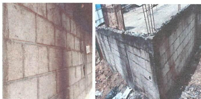
Foto 3: REPELLO DE PAREDES POR FILTRACION DE AGUA
