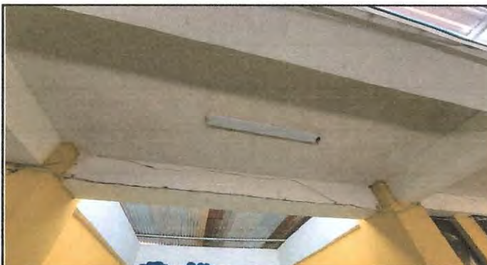
Iluminación: Focos dañados del pasillo de donde se encuentran la Dirección y aulas del establecimiento.
