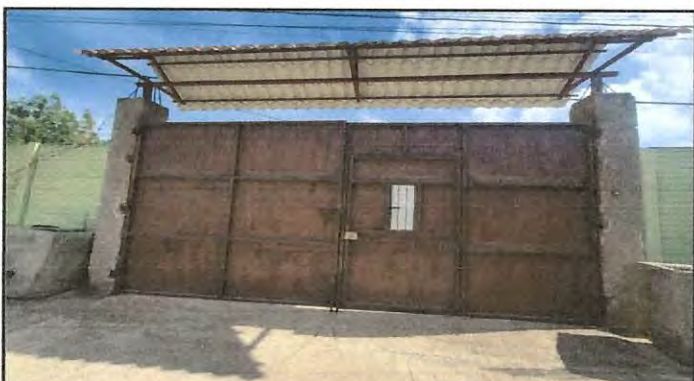
Vista del porton entrada en la escuela columnas rusticas y deterioradas que serán repelladas tanto afuera como adentro
