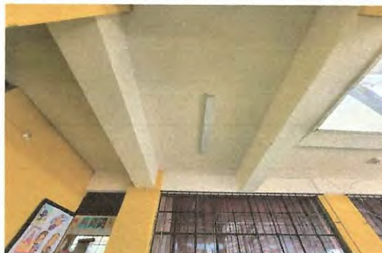
Iluminación: Focos dañados del pasillo de donde se encuentra el aula de párvulos.
