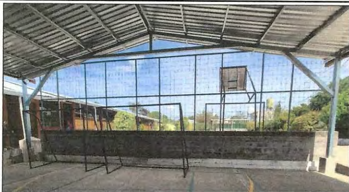
Pared que divide las dos canchas deportivas ligeramente deterioradas se repella ambos lados
