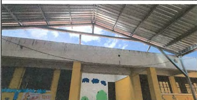
Iluminación: Focos dañados de la iluminación de la cancha y el sector de la parte de la fachada
