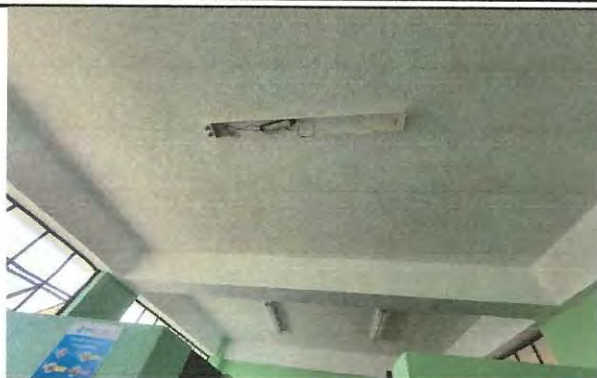
Iluminación, Focos dañados de santuario de mujeres.
