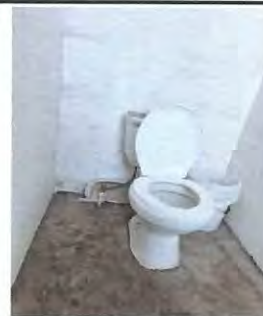
Foto 16: Los sanitarios están en malas condiciones por lo que serán sustituidos por nuevos sanitarios y más pequeños acorde a los estudiantes necesitan.
