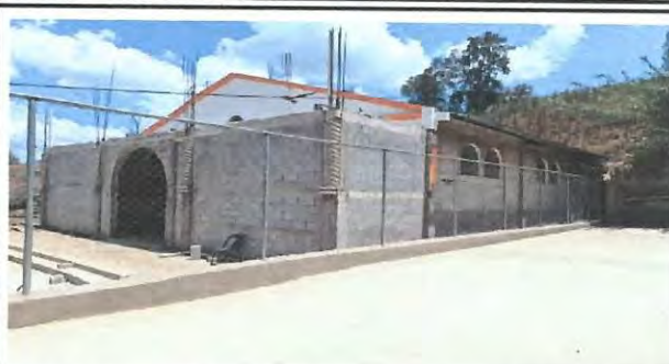
Foto 2: Así es como se encuentra actualmente el muro perimetral pero dentro de todo este perímetro las personas mal intencionadas han cortado la malla para poder ingresar en las instalaciones que ocupa la escuela.
