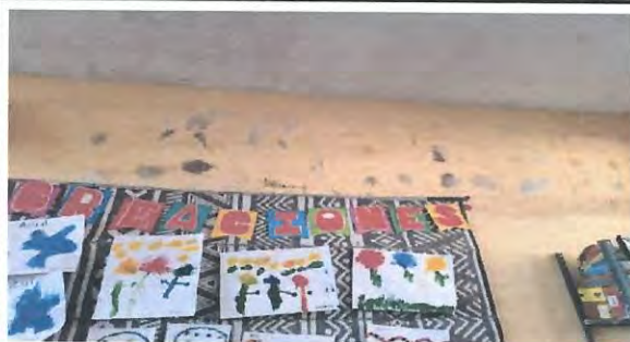
Foto 7: Actualmente las paredes del interior se encuentran con moho y se le aplicará pintura para darle mejor vista.
