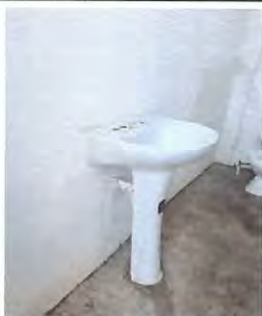
Foto 15: Lavamanos que no tienen grifos ni llaves porque fueron robados pero se les instalará llaves nuevas.
