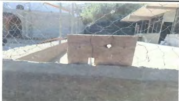
Foto 1: Se puede observar que la malla no presta mayor seguridad ya que es fácil que lo corten y poder entrar en la escuela.
