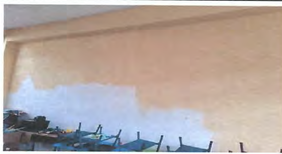
Foto 8: Tramo que se trato de pintar pero no se logro por falta de presupuesto, será pintada en su totalidad.
