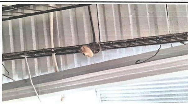
Foto 2: Tubos y plafoneras deterioradas.
