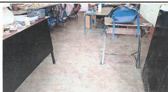
Foto 9: Pisos del salón de Primero "A" ya muy deteriorados.
