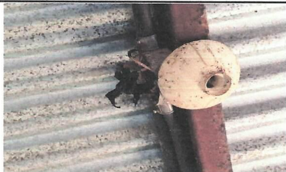
Foto 1: Plafoneras en y cajas deterioradas y en mal estado.
