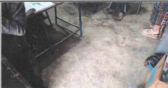
Foto 12: Pisos de Primero "B" ya muy sucios y deteriorados.
