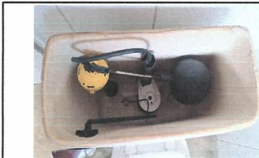
Foto 18: Se observa el juego de la bomba del tanque del sanitario de Quinto que esta en mal estado.
