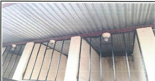
Foto 3: plafoneras y cableado muy obsoleto.
