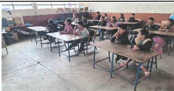
Foto 11: Pisos de Quinto "A" ya muy deteriorados.
