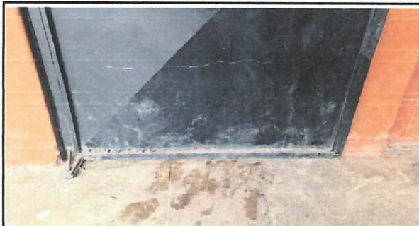
Foto 13: Puerta de Tercero "A" que ya esta con mucha corrosión en la parte de abajo.
