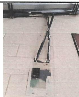
Foto 4: Único tablero para todos los circuitos de la escuela.
