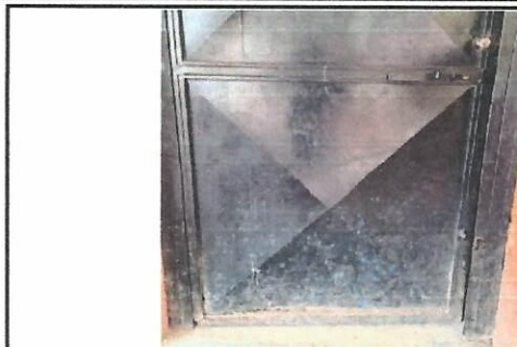
Foto 14: Puerta de Segundo "A" Se observa la corrosión en la parte inferior.
