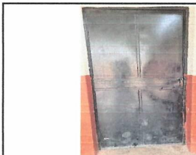
Foto 16: Esta puerta esta demaciado al raz del piso por lo que se dentra que cortar una pulgada para que pueda pegarse el piso de cerámica.
