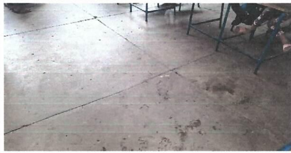
Foto 7: Piso del salón de segundo "A" de torta de cemento muy sucios.
