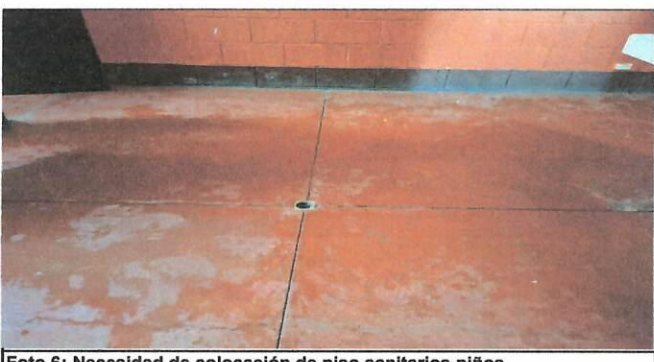
Foto 6: Necesidad de colocación de piso sanitarios niños.
