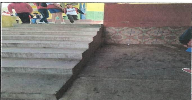
Foto 11: Necesidad de un pasamanos primer nivel.
