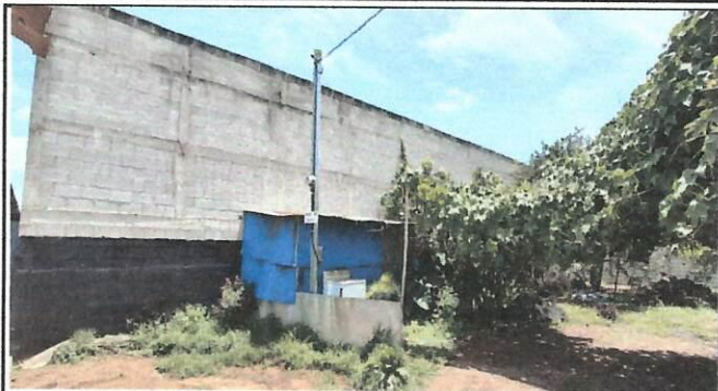
Foto 13: Necesidad de impermeabilizar la parte externa de la pared de párvulos.
