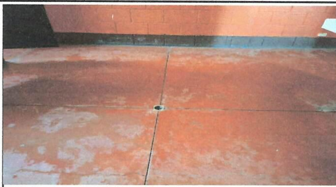
Foto 2: Necesidad de colocación de piso sanitarios niñas.
