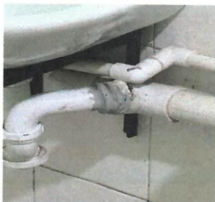
Foto1: La tuberías de agua y drenajes se encuentran en mal estado.
