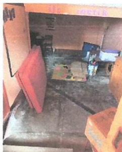
Foto 1: Actualmente la bodega se encuentra ubicada en un primer nivel pero no cuenta con ventilación adecuada.
