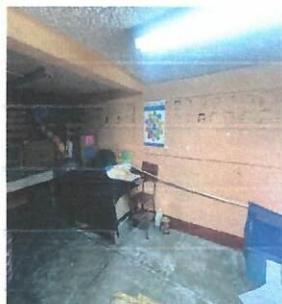
Foto 3: No cuenta con la iluminación suficiente.
