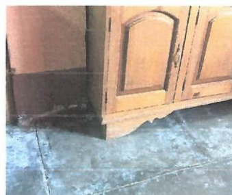
Foto 4: La humedad se está filtrando en las paredes.
