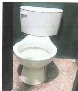
Foto 2: Los baños se encuentran deteriorados, sin tapaderas, astillados, las manesillas y sapitos no funcionan
