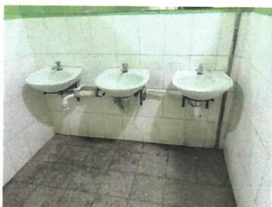
Foto 3: Las fugas de las tuberías de los baños y lavamanos provocan charcos o que las llaves de paso de agua se cierran y no se cuente con el recurso
