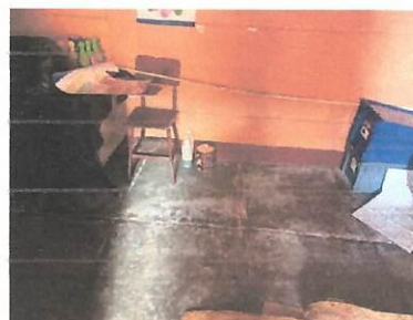
Foto 2: El piso se encuentra en mal estado y guarda humedad.
