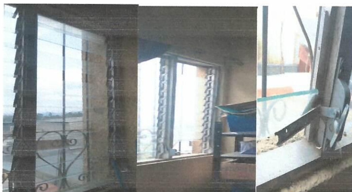
Foto 4: Ventanas en mal estado.
