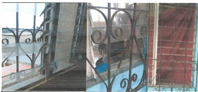
Foto 5: Ventanas en mal estado.
