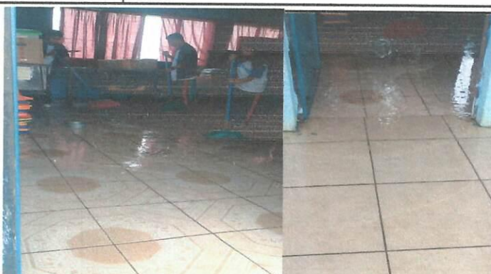
Foto 2: Techo en mal estado.
