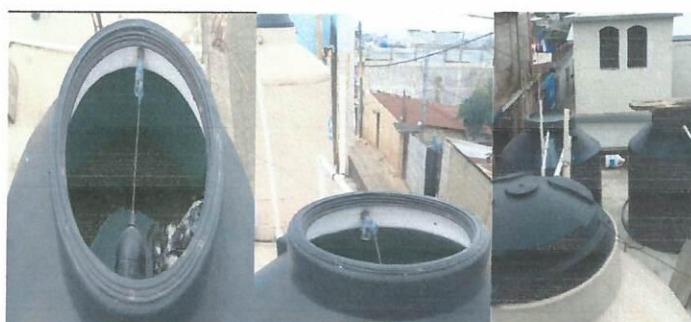
Foto 6: Tinacos en mal estado.
