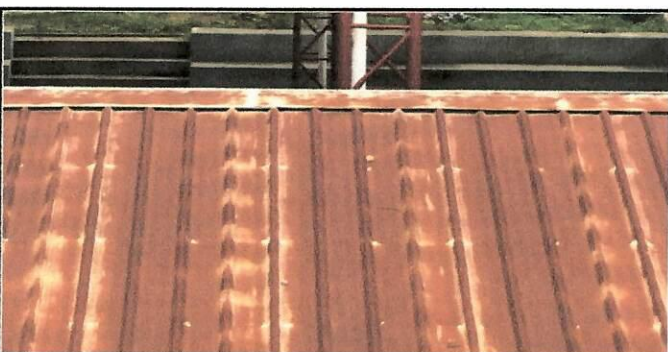
Foto 5: las laminas ya estan en mal estado
