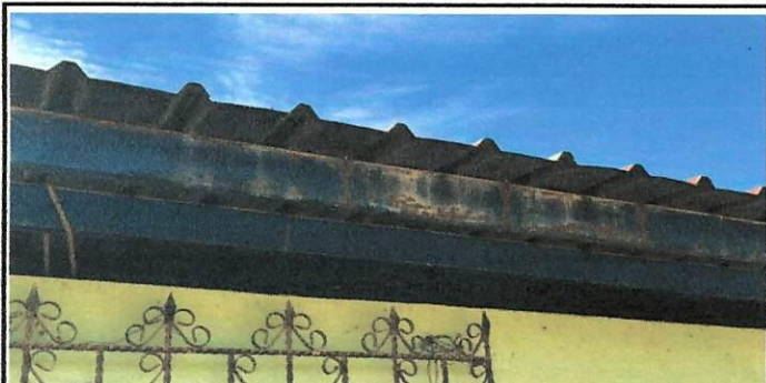
Foto1: las costaneras necesitan ser lijadas y pintadas
