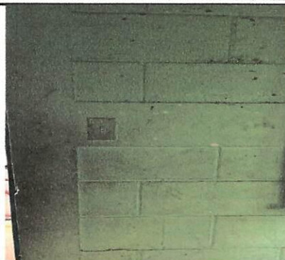
Foto 2: ls paredes del establecimiento estan demaciado sucias ya que tienen mas de 10 años de no ser pintadas
