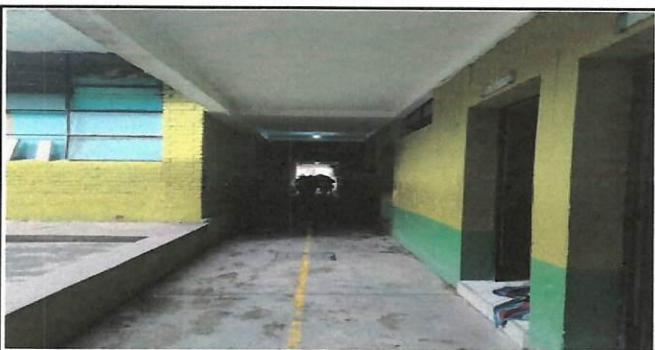
Foto 3: Corridor trasero, previsto para colocar iluminación
