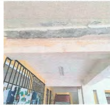
Foto 4: aca se logra ver el daño causado por la filtración
