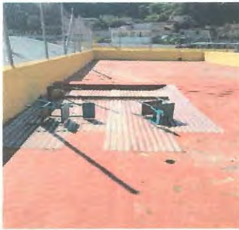
Foto 3: se ve la necesidad que ha de colocar el techo para proteger la terraza.
