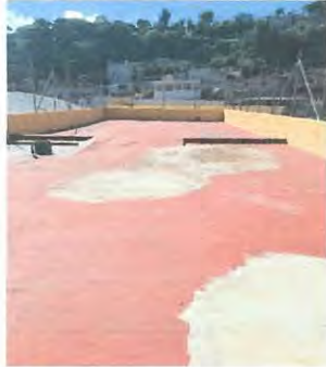
Foto 1: Se hace necesario realizar el proyecto de Techo porque al pasar el tiempo la terraza se ha ido deteriorando a causa del sol y la lluvia
