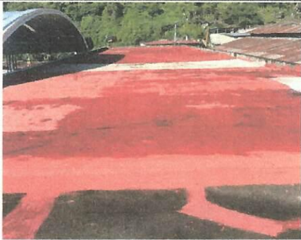
Foto 1: Este es el espacio donde se hará la Estructura Metálica. Ya tiene impermeabilizante pero aún así se filtra el agua
