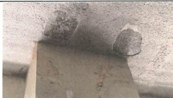
Foto 6: Se filtra el agua hasta en las columnas como que fuera nacimiento de agua.
