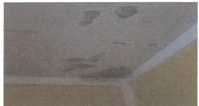
Foto 4: filtraciones en terraza
