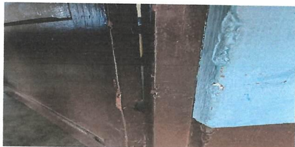
Reemplazo de puerta por deterioro de la madera y falta de chapa.
