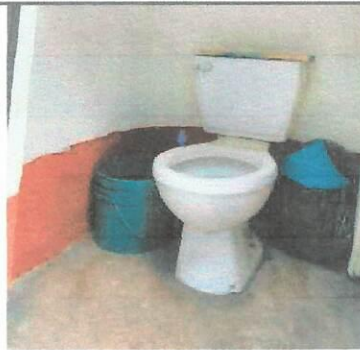
Foto 4: Sustrucción inodoro (incluye contrallave y tubería)
