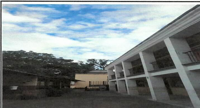
Foto1: patio del establecimiento educativo central falta de estructura de techo y cubierta de lamina, falta de iluminación adecuada
