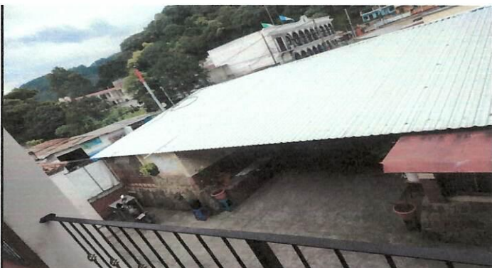
Foto 3: patio del establecimiento educativo central falta de estructura de techo y cubierta de lamina, los estudiantes realizan ejercicio para educación física, exponiéndose al sol y la lluvia, falta de iluminación
