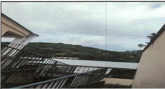
Foto 6: lluvia entra a los corredores
