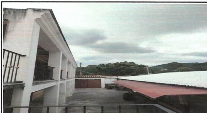
Foto 2: patio del establecimiento educativo central falta de estructura de techo y cubierta de lamina, lluvia entra a los corredores poniendo en riesgo a los estudiantes, falta de iluminación adecuada.
