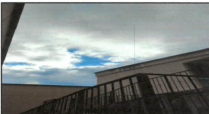
Foto 4: rampa del centro educativo, falta de estructura de techo y cubierta de lamina, falta de iluminación adecuada.
