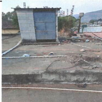
Foto 4: Limpieza de Losa caseta y tubería en mal estado
