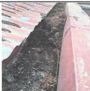
Foto 8: Limpieza de canal lleno de Basura
