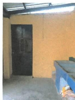
Foto 2: puerta en mal estado y falta una ventana para iluminar y ventilar
