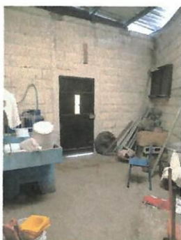
Foto 3: área de pila de cocina en mal estado
