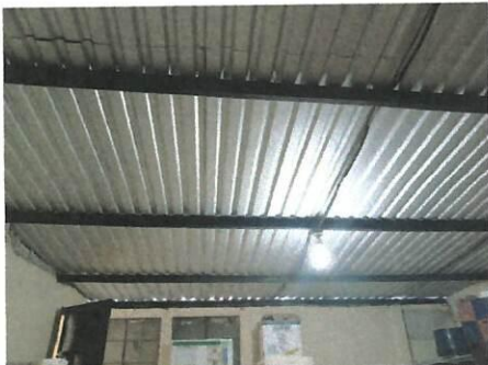
Foto 5: techo de lámina muy bajo provocando mucho calor
