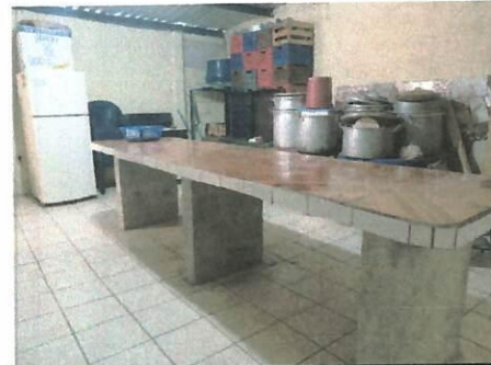
Foto 6: isla de cocina en mal estado
