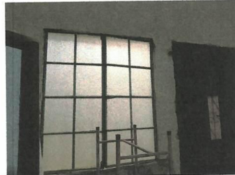
Foto 4: ventana de cocina en mal estado
