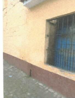
Foto 2: parte frontal de la escuela en mal estado
