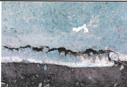
Foto1: pared agrietada de la parte inferior, se puede observar que está bastante profunda
