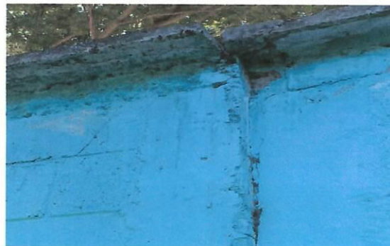
Foto 2: La pared está separada aproximadamente 6 centímetros
