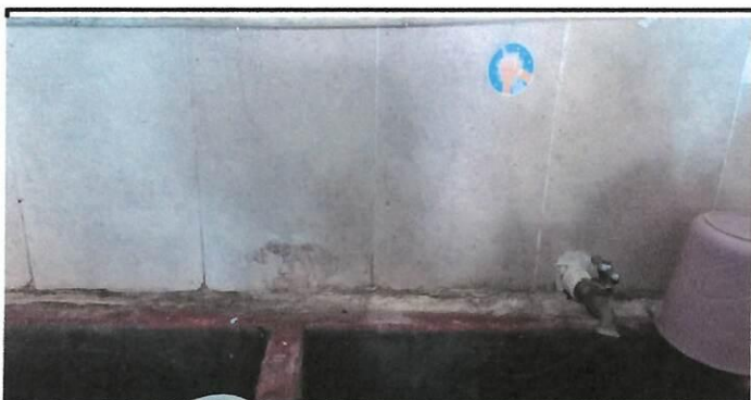
Foto 5: estado actual del azulejo de la cocina. Se encuentra dañado y manchado por lo que es anti higiénico y en esta área se cocina para 201 niños. Comprendidos entre 3 y 6 años de edad
