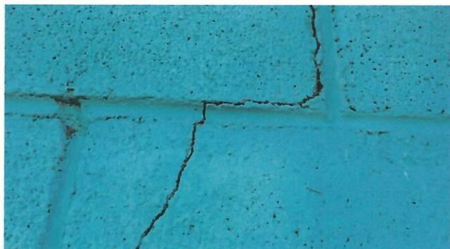
Foto 3: Este agrietamiento recorre toda la pared desde su base hasta la parte superior
