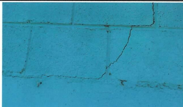
Foto 4: Así se encuebra la pared en un tramo de 16 metros de longitud
