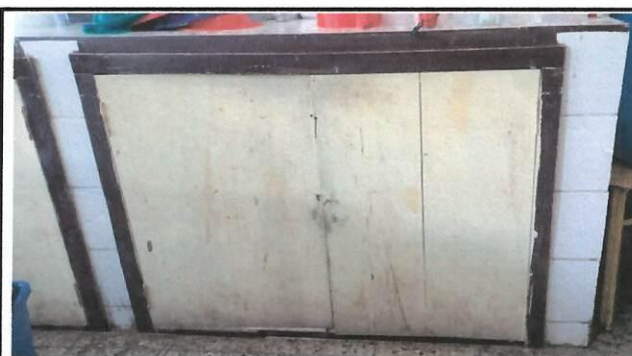
Foto 6: puertas de los muebles de piso, los cuales no cuentan con azulejo por dentro.
