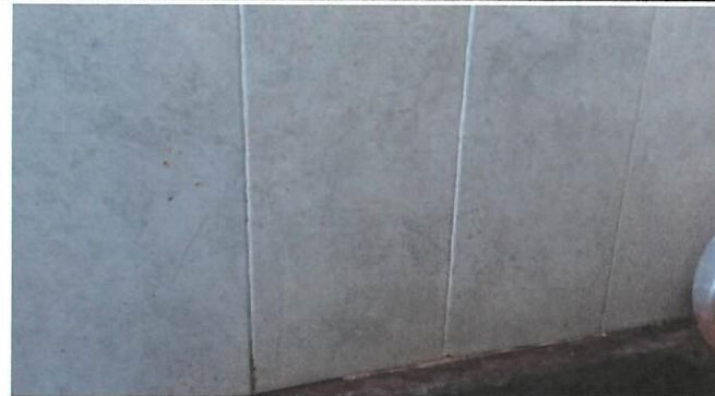
Foto 8: todo el azulejo se encuentra en mal estado, rayado y manchado.
