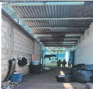
Foto 10: Este espacio por mucho tiempo fue utilizado como bodega, debido a que las láminas se arruinaron y representaban un peligro para los niños se deshabilitó, pero la necesitamos
