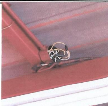
Foto 1: Sobrecarga de cables de energía eléctrica.
