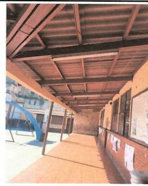
Foto 10. Lámparas tubo led en mal estado y los cables mal organizados.
