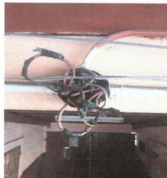
Foto 2: Sobrecarga de cables de energía eléctrica.
