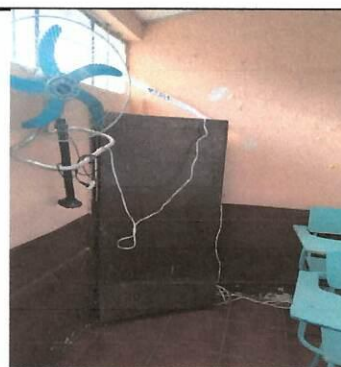
Foto 4: Cables de ventiladores mal organizados dentro de los salones de clase.
