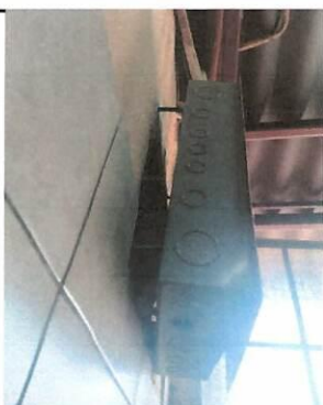
Foto 5: Caja de flípones en mal estado.
