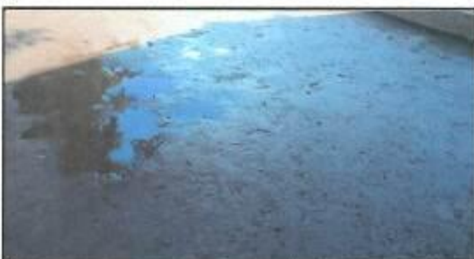
El secado del patio es bastante tardado y provoca la proliferación de insectos debido a la humedad.
