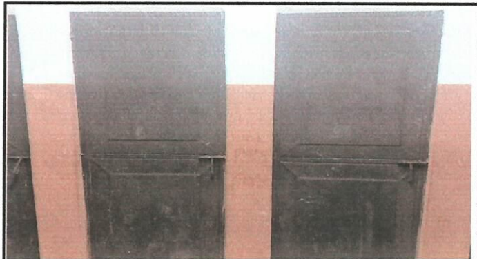
Foto 8: Las puertas de los sanitarios están muy rayadas, dan mal aspecto para una institución escolar.
