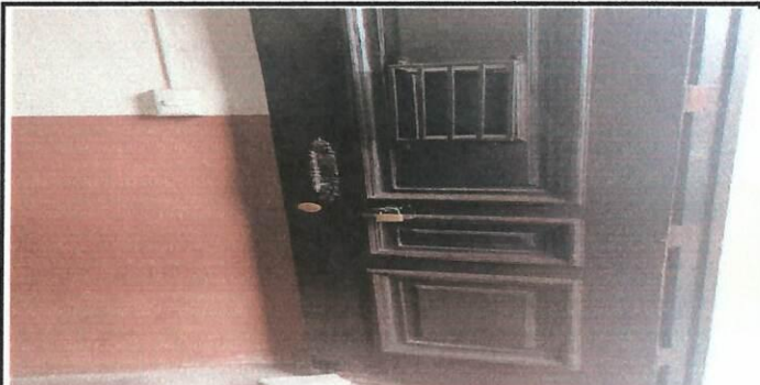
Foto 12: La puerta de entrada está caída, la ventada le falta tornillos, la pintura ya está muy desgastada.
