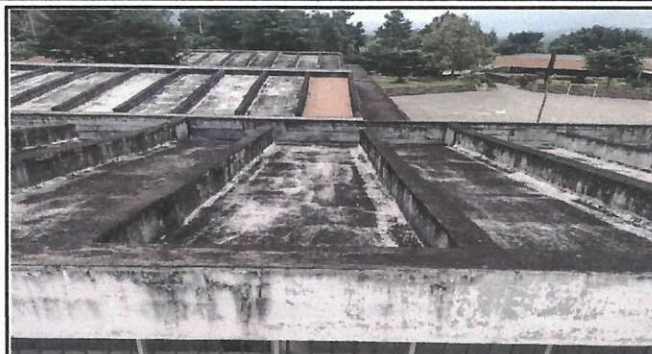
Foto 1: área dañada en loza, aplicación de impermeabilizante
